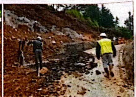
Ya no es posible dar paso ni provisionalmente. La antigua carretera está más empinada, se hundió más y construyen unos gaviones por donde antes subían y bajaban los carros. El paso en cualquiera de sus formas, a pie o en carro, está prohibido.
