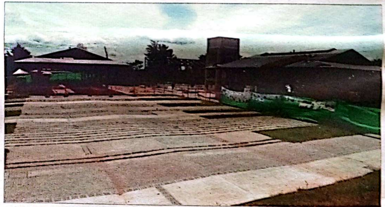
Las obras de la plazoleta, suspendidas hace más de un año.
