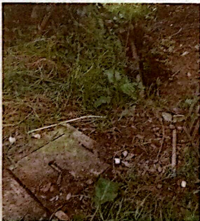
La foto, tomada el 29 de septiembre, corresponde a las cajas de la zona de El Recreo, donde en cuatro cajas desembocaron los sistemas de desagüe de 17 predios.
