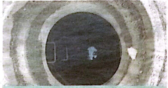
El manhole de la evidencia. El día que se tomaron estas fotos, las aguas residuales caían directamente a la Quebrada Santa Elena. Foto tomada el 16 de agosto.
